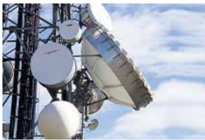
Figura 54 – Turn de telecomunicații cu fibră optică
